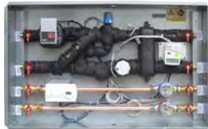
Riscaldamento e Raffrescamento alta e bassa temperatura circuiti indipendenti con separazione idraulica
